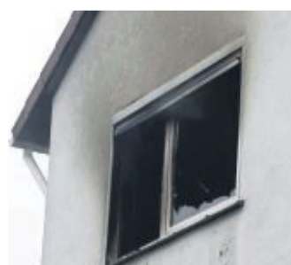
Rauchgeschwärtzt: Flammen schlugen aus diesem Fenster.
