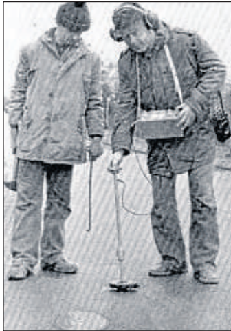
Der Staufenberger Bauamtsleiter Karl-Heinz Ziegenhorn sucht mit einem Mitarbeiter ein Leck im Wasserleitungsnetz der Gemeinde. Repro: Till
