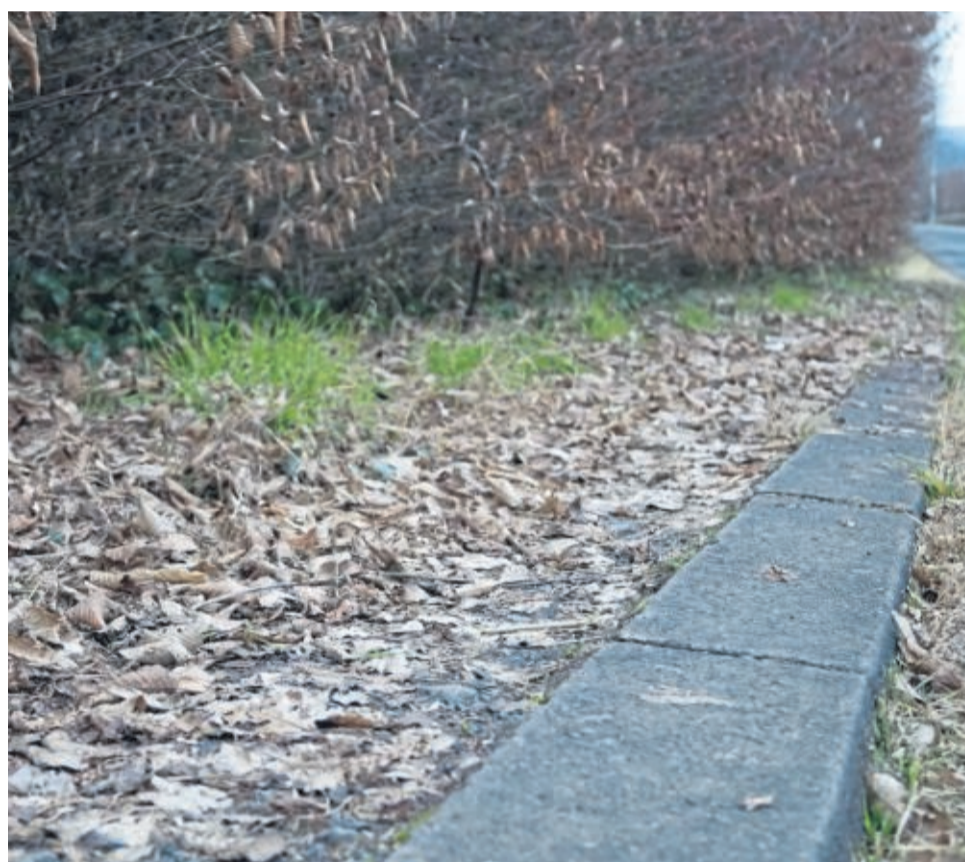
Zunehmend verwahrlost: Der Gehweg neben der Straße am Hedemündener Bahnhof verschwindet unter Laub und im Gestrüpp.
