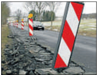
Frostschaden: Die Hessen reparieren ihn, weil die Landesstraße hier schon auf hessischem Gebiet liegt. Archivfoto: Krischmann
